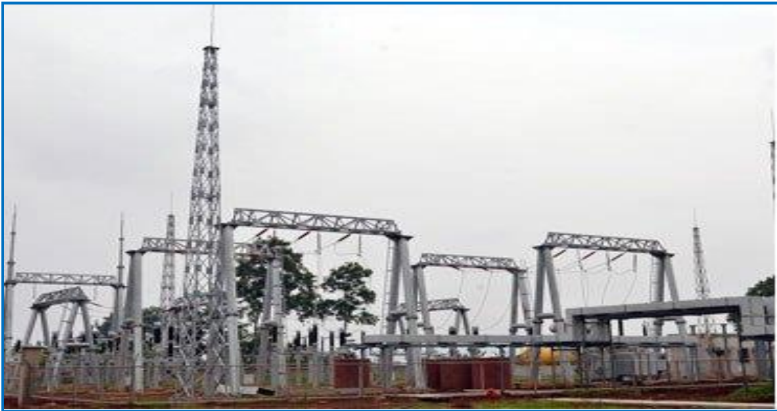
Figure 9: Installations de distribution de l'électricité de la REGIDESO
